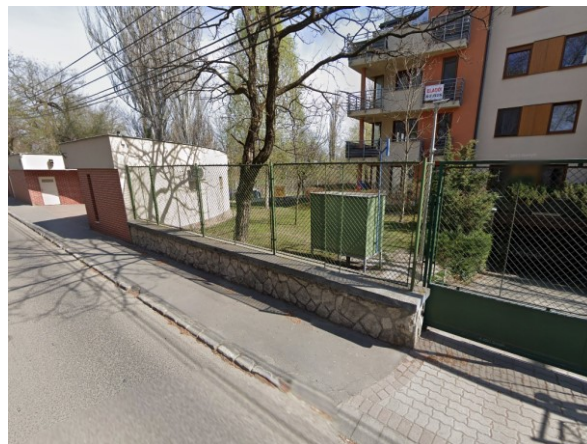
Lemezház nagyközep/ kisnyomású gáznyomásszabályzó (forrás: maps.google.com)
